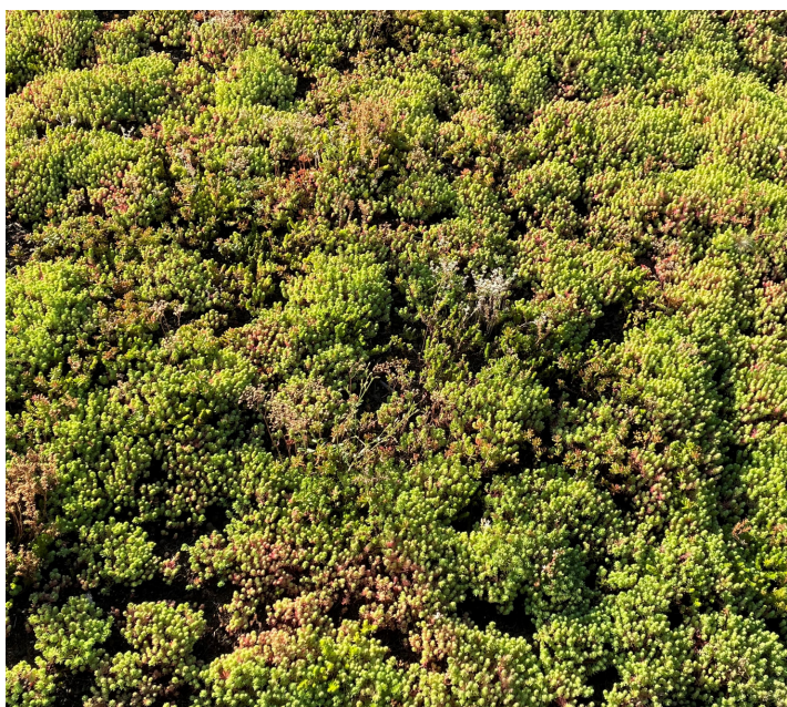
Toit végétal MAC - Crédit photo - service communication
